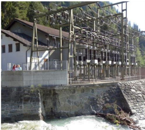
Alte Anlage – vor Erneuerung
